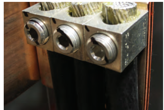
Conexión a bus de cobre con zapatas bimetálicas mecánicas
