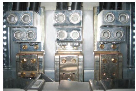
Conexión a bus de cobre utilizando tablillas mecánicas para circuitos en paralelo
